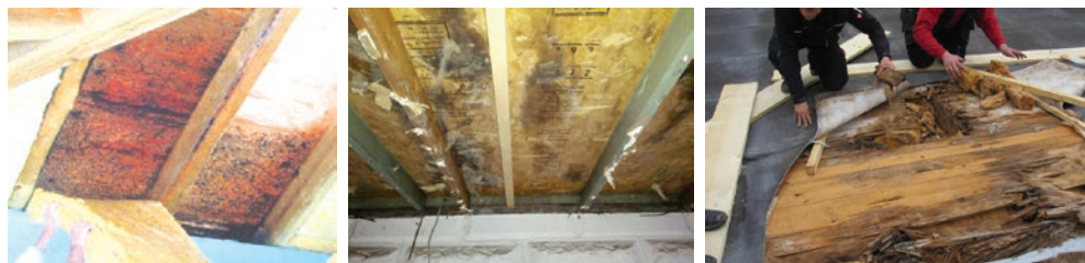
Slika 34 Štete izazvane pogreškama u izvedbi krovišta
