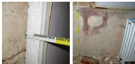
Slika 85 Razvoj gljivica nakon skidanja sloja unutarnje toplinske izolacije
