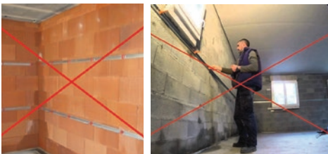
Slika 26 Vlažni zidovi prije izvođenja sustava unutarnje toplinske izolacije
