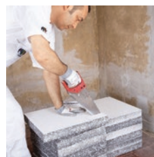
Ploče toplinske izolacije kroje se pilama ili nožem pri čemu ih je treba očistiti od prašine i prljavštine
