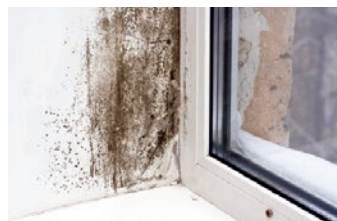
Slika 25 Rast gljivica i plijesni zbog kondenzacije na špaleti prozora
