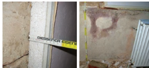
Slika 27 Razvoj gljivica nakon skidanja sloja unutarnje toplinske izolacije
