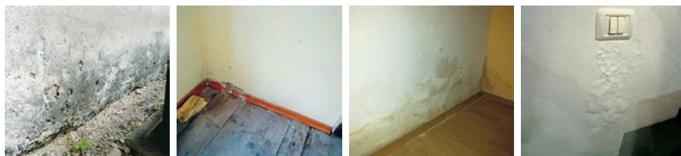
Slika 34 Primjeri oštećenja žbuke zbog kapilarnog dizanja vlage i oborinske vode, zbog loše ili nepostojeće hidroizolacije ili pak spriječenog isušivanja ugradbene vlage
