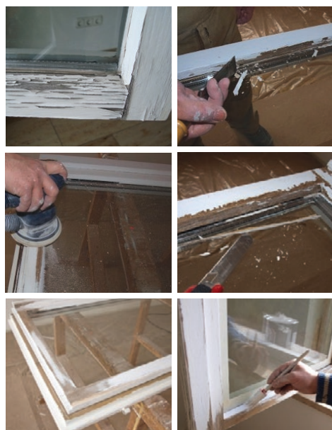
Slika 39 Primjer starog naliča, skidanje brtve sa stakala i brušenje starog naliča s drvene stolarije, zaglađeno prozorsko krilo i nanošenje premaza za drvo
