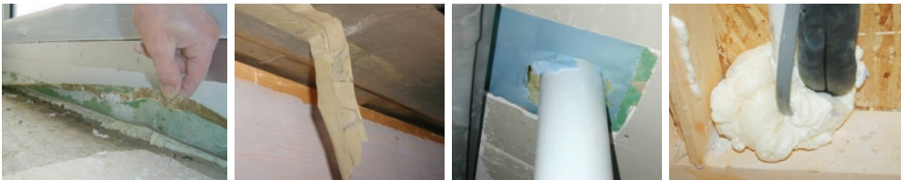
Slika 29 Štete nastale upotrebom neadekvatnih materijala za brtvljenje zrakonepropusnog sloja
