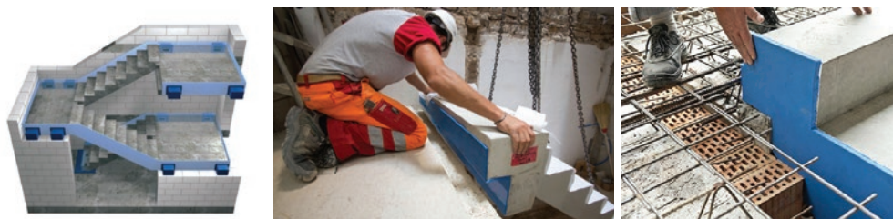
Slika 20 Ugradnja predgotovljenih elemenata stubišta s riješenim detaljima toplinskih mostova i prijenosa zvuka
