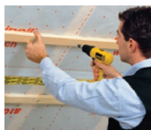
Pričvršćenje podkonstrukcije za oblogu gipskartonskim pločama preko parne brane (dozvoljeno, ako se dovoljno stisnu obje letve podkonstrukcije)
