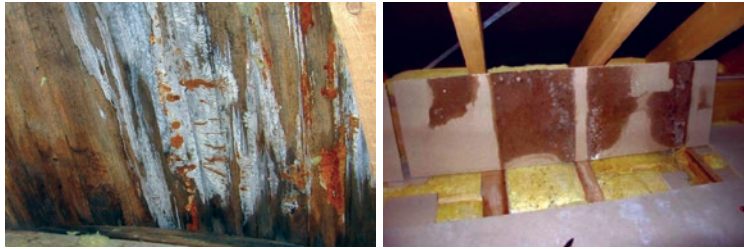
Slika 32 Nekontroliran ulazak zraka u hladniji dio ovojnice uzrokuje propadanje materijala
