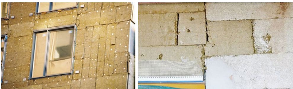
Slika 50 Neadekvatno postavljanje ploča toplinsko-izolacijskog materijala
