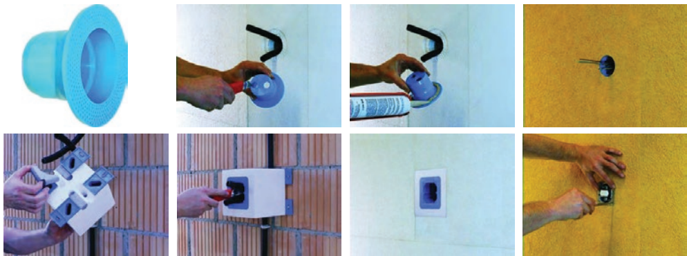
Slika 40 Montažni elementi za montažu vanjskih rasvjetnih tijela i drugih uređaja vezanih na električnu energiju
