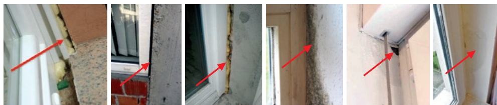
Slika 3 Građevinska šteta nastala zbog loše ugradnje prozora
