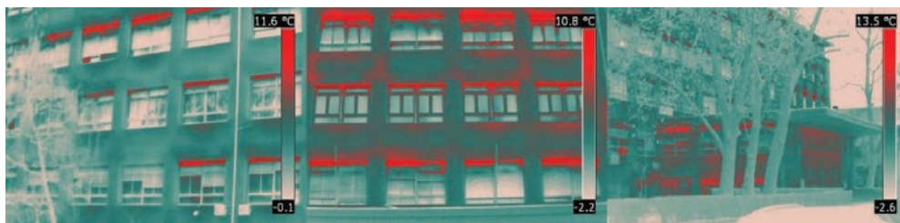
Slika 2 Termogrami povećanih gubitaka topline kroz prozore u odnosu na ostale dijelove zgrade
