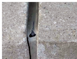
Slika 26 Premalo brtvila koje zatim ne može podnijeti pomake predgotovljenih panela te dolazi do pucanja brtvila
