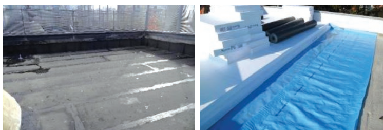
Slika 53 Parna brana od bitumenske trake s uloškom od Al folije i od PE folije (desno)
