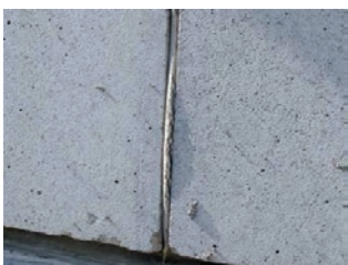
Slika 24 Primjer deformacije brtvila uslijed deformacije zidnih panela
