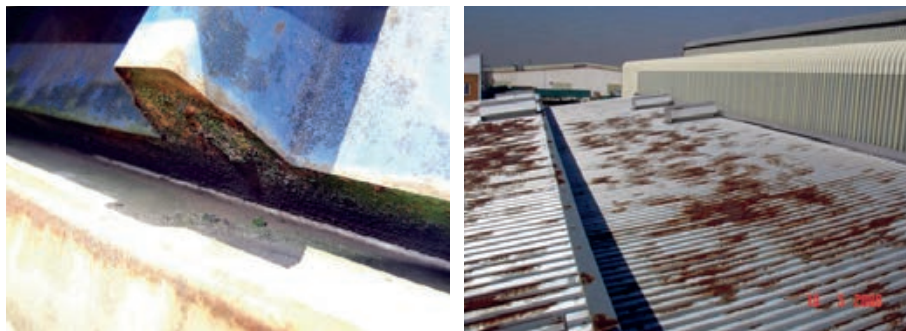
Slika 3-144 Propadanje toplinske izolacije od PIR-a i korozija panela [7]
