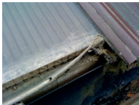
Loša ugradnja ploča (ne dosežu do oluka)
