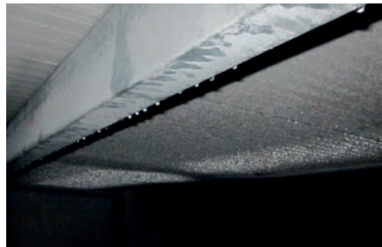
Slika 3-122 Primjer stvaranja kondenzata na podgledu krovnih panela zbog lošeg brtvljenja [7]
