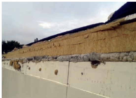
Slika 3-130 Primjer lošeg brtvljenja spoja krovnih i zidnih panela [7]
