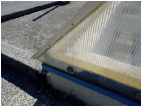
Neodgovarajuće brtvljenje, nemoguće postizanje zrakonepropusnosti vanjske ovojnice
