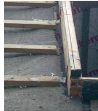
Veliki prostor kao i opšav prozora nezaštićeni paropropusnom-vodonepropusnom folijom
