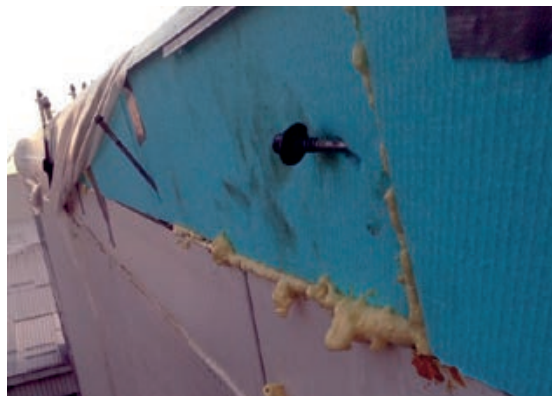
Slika 3-128 Primjer neodgovarajuće izvedbe spoja krovnih i zidnih panela [7]
