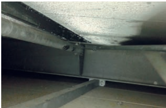
Slika 3-121 Primjer stvaranja kondenzata na podgledu krovnih panela zbog lošeg brtvljenja [7]
