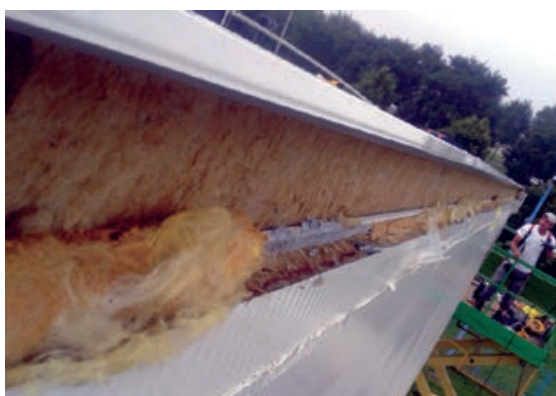
Slika 3-129 Primjer loše izvedbe spoja krovnih i zidnih panela [7]
