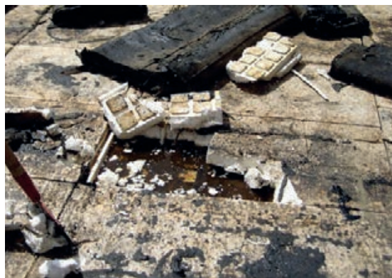
Slika 6-41 Primjer oštećenja termoizolacije i vode ispod sloja termoizolacije [349]
