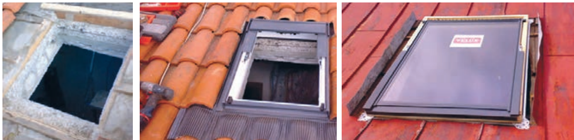
Slika 1-174 Primjer loše ugrađenih krovnih prozora [133], [128]
