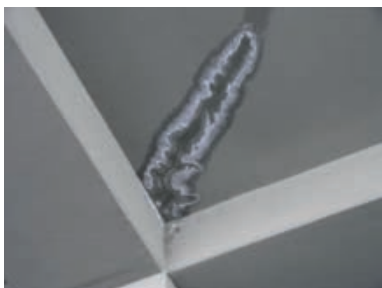
6-51 Procurivanje vode kroz pukotinu u armiranobetonskoj stropnoj ploči ispod prohodnog ravnog krova [7]
