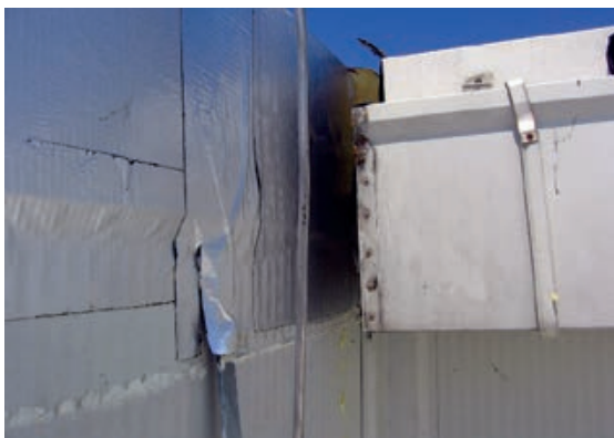
Slika 3-135 Primjer neodgovarajućeg brtvljenja proboja gromobrana hidroizolacijskom trakom [7]
