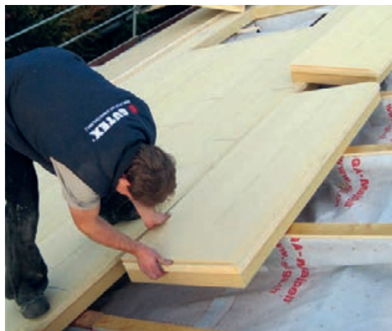
Slika 2-10 Primjer loše izvedbe izolacije: kako je međuprostor između rogova ostao neizoliran, pojava strujanja u međuprostoru može povećati gubitke topline [146]
