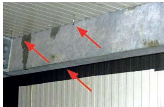
Slika 3-124 Primjer lošeg pričvršćenja snjegobrana (vijci), pojave kondenzata (na metalnom nosaču) i lošeg brtvljenja strehe (ljepljiva traka) [7]
