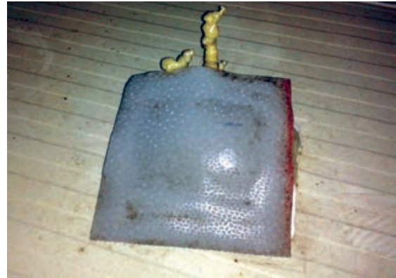
Slika 3-138 Primjer neodgovarajućeg krpanja oštećenja na toplinsko-izolacijskom panelu [7]
