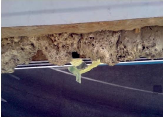
Slika 3-131 Primjer lošeg brtvljenja spoja krovnih i zidnih panela [7]
