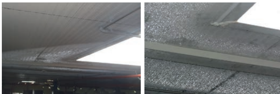
Slika 1-191 Primjer pojave kondenzata zbog nepostizanja zrakonepropusnosti kod ugradnje kupole za odimljavanje [7]
