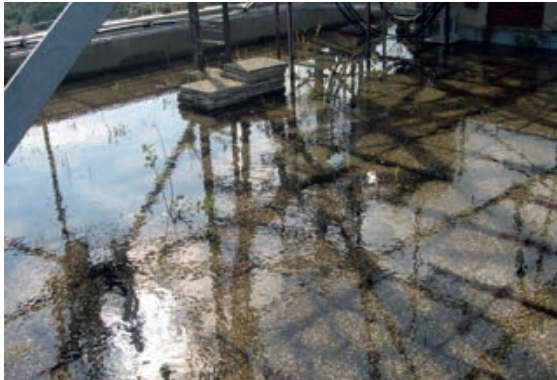
Slika 6-44 Primjer zadržavanja vode na ravnom krovu zbog neodgovarajuće odvodnje [7]
