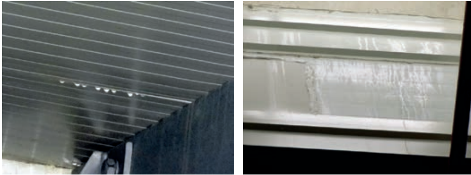
Slika 3-107 Kondenzacija zbog lošeg brtvljenja krovnih toplinsko-izolacijskih panela, zrakopropusna ovojnica [7]
