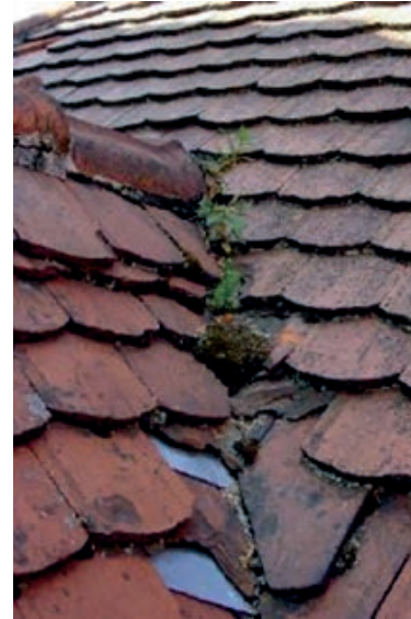
Slika 1-53 Loše izvedena uvala [7]
