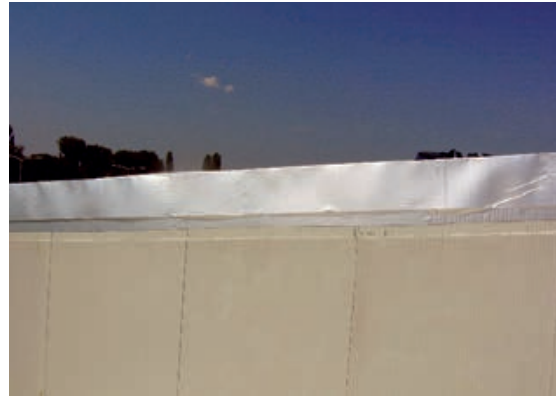
Slika 3-134 Primjer neodgovarajućeg brtvljenja hidroizolacijskom trakom [7]
