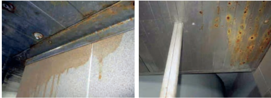
Slika 3-143 Korozija uzrokovana korištenjem sredstava za čišćenje na bazi klora [261]
