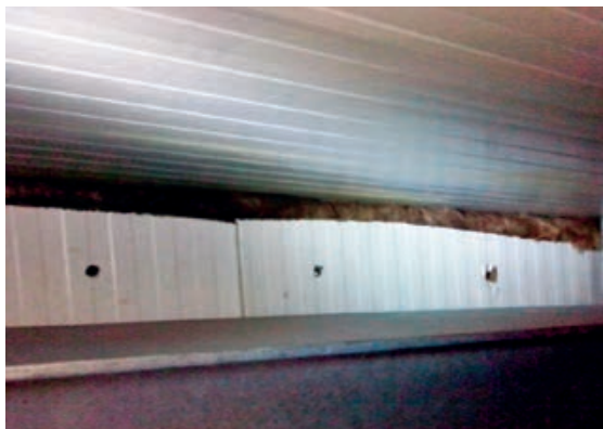
Slika 3-127 Primjer neodgovarajuće zabrtvljenog spoja krovnih i zidnih panela [7]
