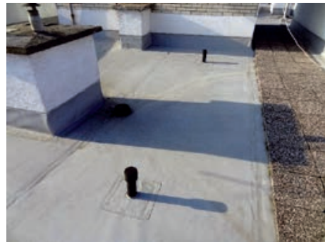
Nezaštićena hidroizolacijska membrana ventiliranog ravnog krova sa servisnim koridorom od kulir ploča
