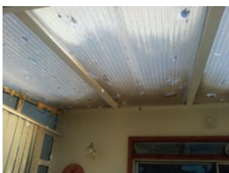
Oštećenja uslijed tuče
