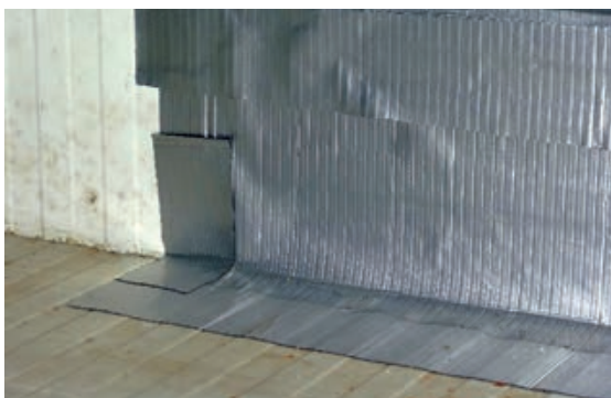
Slika 3-123 Primjer lošeg brtvljenja strehe ljepljivom trakom (tzv. American tape) [7]
