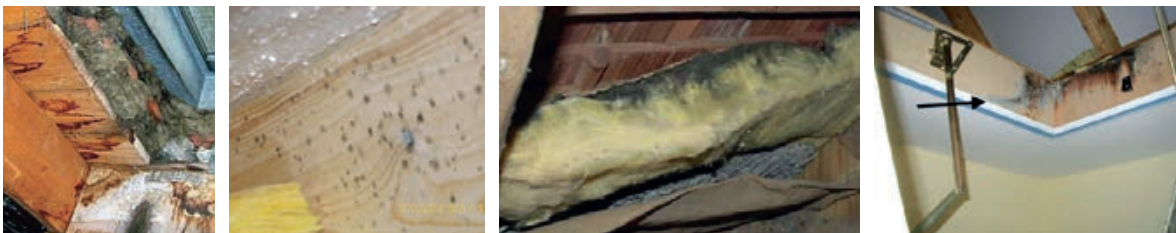
Slika 1-75 Pogreške u izvedbi krovišta zbog neznanja ili nemara [57], [58], [59], [60]
