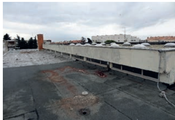
Slika 6-47 Primjer nezaštićene bitumske hidroizolacije neprohodnog ravnog krova [7]
