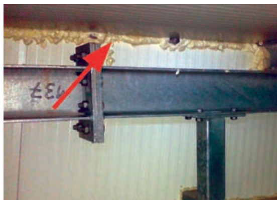
Slika 3-126 Primjer neadekvatno zabrtvljenog spoja krovnih i zidnih panela [7]
