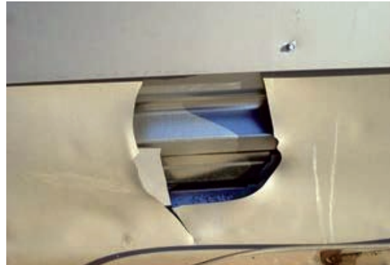
Slika 6-38 Oštećenje hidroizolacije zbog nedostatka UV stabilizatora [349]
