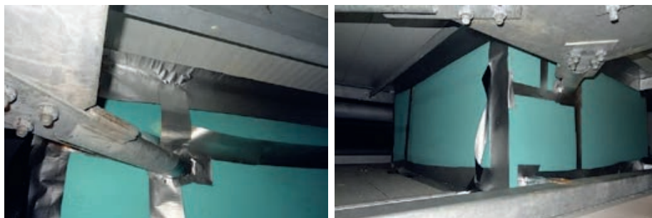
Slika 1-190 Primjer nekvalitetno izvedene zrakonepropusnosti kod ugradnje kupole za odimljavanje [7]
