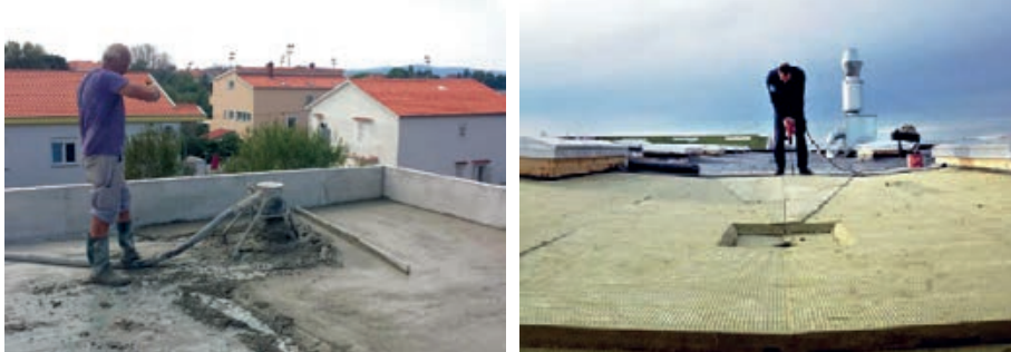
Slika 6-12 Izvedba betona u padu i toplinska izolacija u nagibu za postizanje korektne odvodnje ravnog krova [337], [6]
