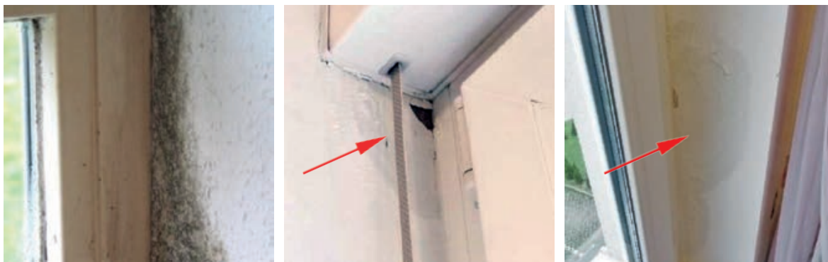
Slika 1-147 Pojava gljivica i vlaženja zida zbog loše ugradnje prozora [7]
