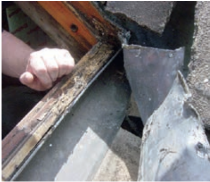
Truli doprozornik krovnog prozora - Limeni opšav bio je postavljen preko opšava prozora što je dovelo do ulaska vode u krov
