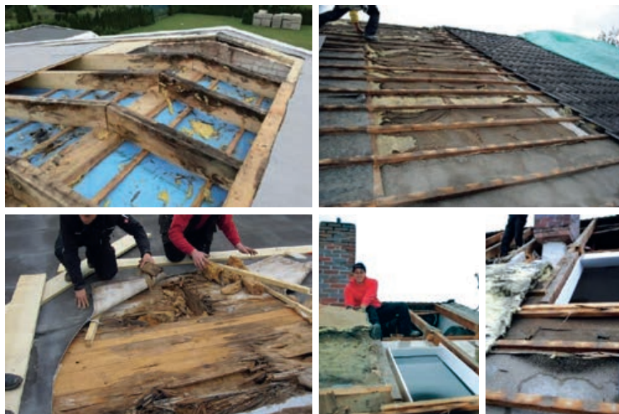
Slika 1-44 Primjer vlažnog i trulog drvenog krova [31]
