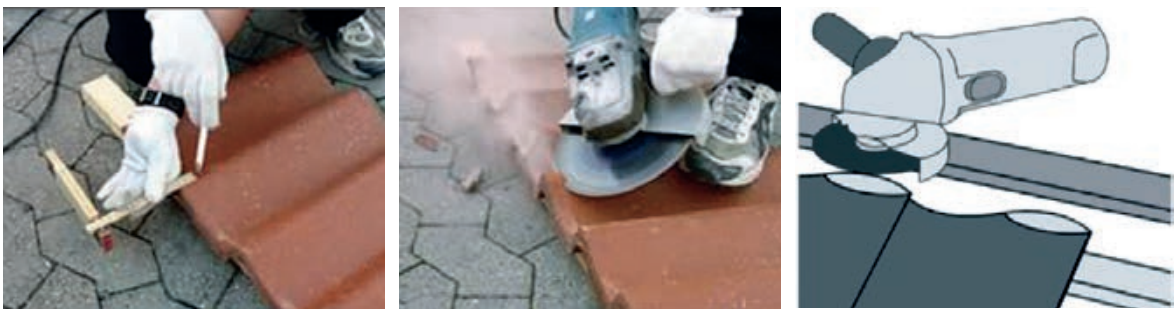
Slika 1-164 Potreba prilagodbe krovnog pokriva ugradnji krovnog prozora i opšavu [130]
