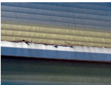
Pukotine na pločama uzrokovane starenjem uslijed UV zračenja
