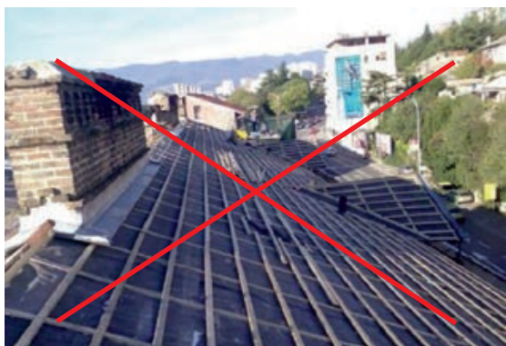
Slika 1-40 Primjer bitumenske ljepenke na krovu - izbjegavati [29]
