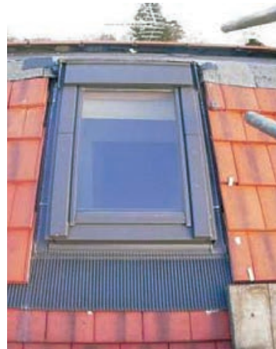
Položaj krovnog prozora previsoko na krovu (pod sljemenom)
