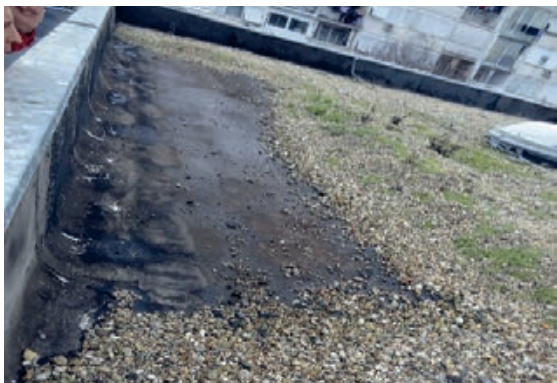
Slika 6-46 Primjer šljunkom zaštićenog ravnog krova – šljunak je odnešen vjetrom [7]
