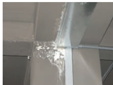
6-53 Primjer pokušaja sanacije problema procurivanja ravnog krova izvođenjem kanalice koja skuplja vodu [7]
