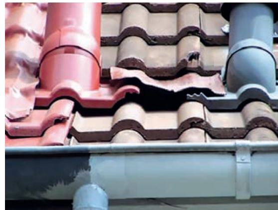
Slika 1-58 Primjer loše izvedenog proboja krova [40]
