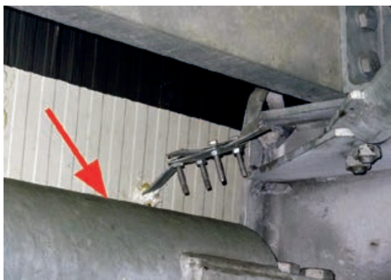
Slika 3-125 Primjer lošeg brtvljenja prodora gromobranske instalacije korištenjem silikonskog kita [7]
