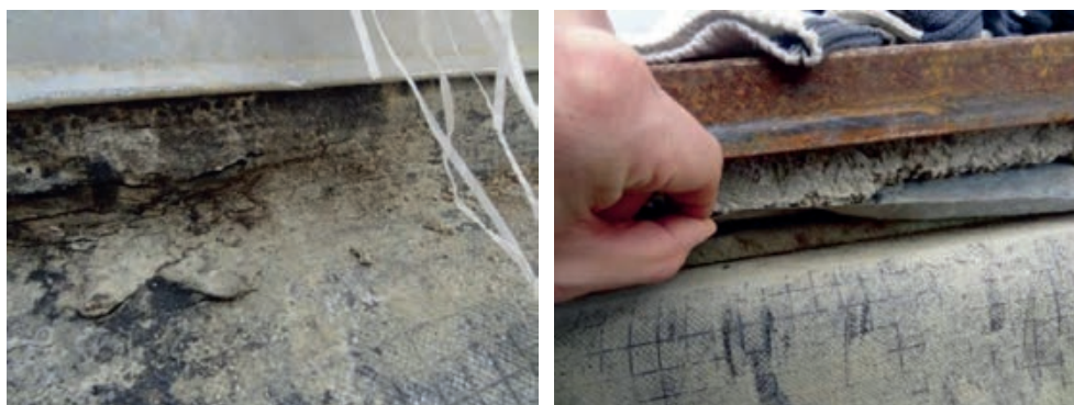
Slika 1-7 Oštećenje hidroizolacije ravnog krova [7]
