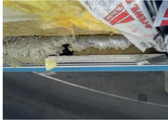
Slika 3-132 Primjer lošeg brtvljenja spoja krovnih i zidnih panela [7]
