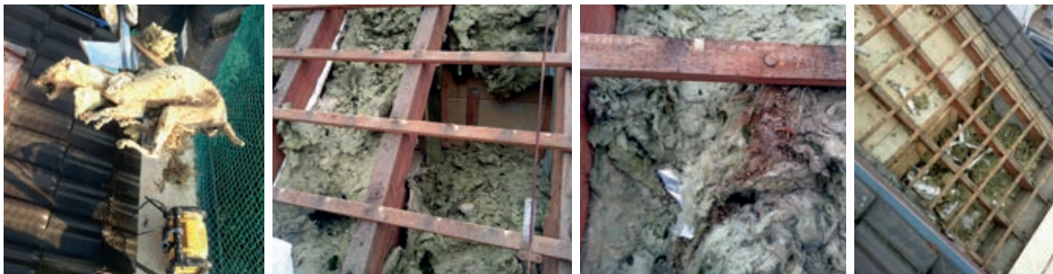
Slika 1-49 Oštećenje toplinske izolacije zbog glodavaca [35]
