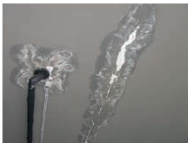
6-52 Procurivanje vode na vodolovnom grlu i pukotini AB stropne ploče [7]
