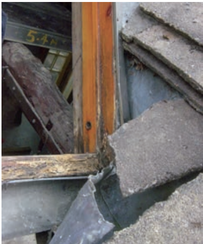
Krovni prozor ugrađen u uvalu krova, bez rješenja za odvođenje kišnice
