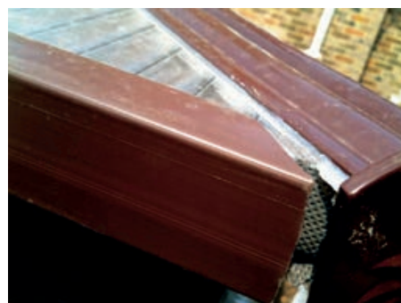
Loše zatvaranje otvorenih krajeva ploča
