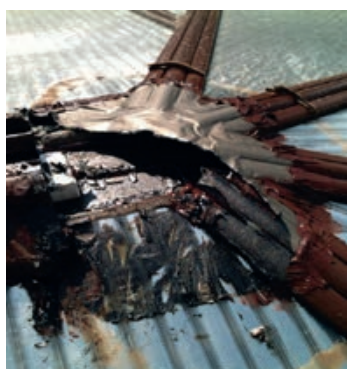
Neodgovarajuće brtvljenje spojeva ploča
