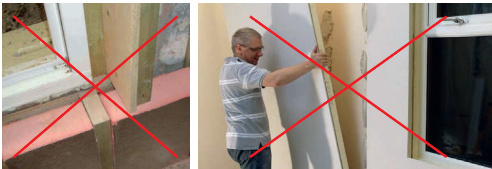
Slika 2-42 Prikaz loše ugradnje sustava unutarnje toplinske izolacije [106], [107]
