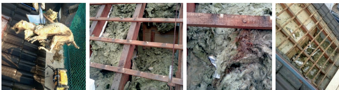
Slika 2-97 Oštećenje toplinske izolacije zbog glodavaca [138]
