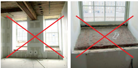
Slika 2-33 Izvedena unutarnja izolacija stana bez izolacije prozorske klupčice nije preporučljiva [101]
