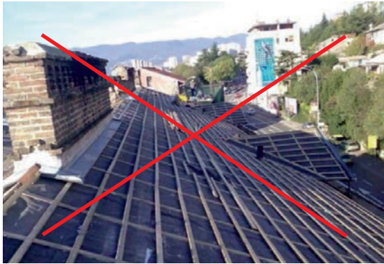
Slika 2-88 Primjer bitumenske ljepenke na krovu - izbjegavati [72]
