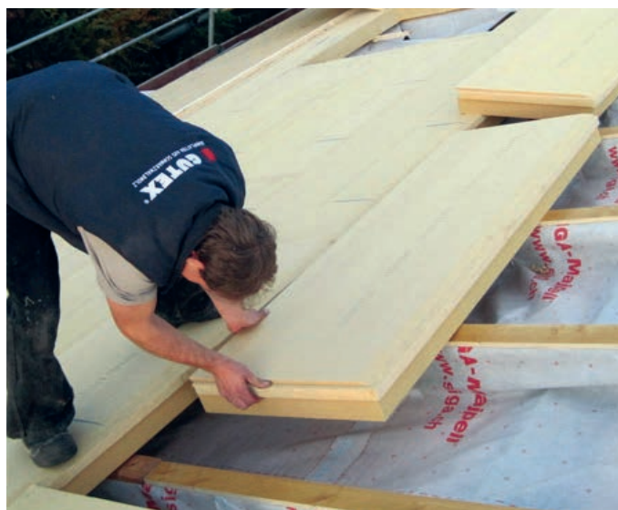
Slika 2-115 Primjer loše izvedbe izolacije jer je međuprostor između rogovca ostao neizoliran; pojava strujanja u međuprostoru može povećati gubitke topline [151]
