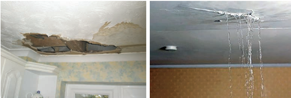
Slika 1-76 Štete uzrokovane lošom izvedbom kišne brane [76], [77]
