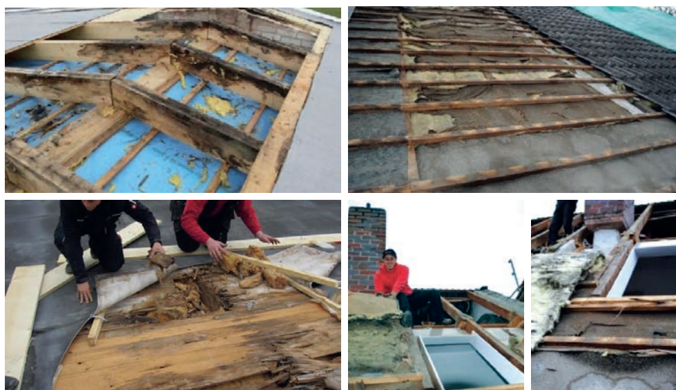
Slika 2-92 Primjer vlažnog i trulog drvenog krova [133]
