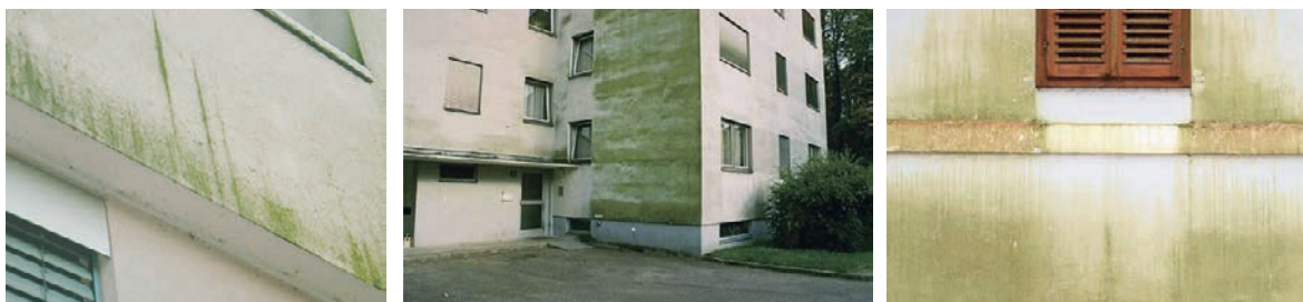
Slika 2-106 Pojava algi na završnom sloju ETICS sustava. S vremenom, posebno na rubu gdje nema okapnice, dolazi do odvajanja žbuke zbog kiše koja stalno kaplje
