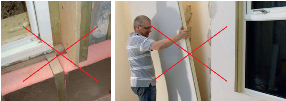
Slika 3 21 Prikaz loše ugradnje sustava unutarnje toplinske izolacije [166], [167]
