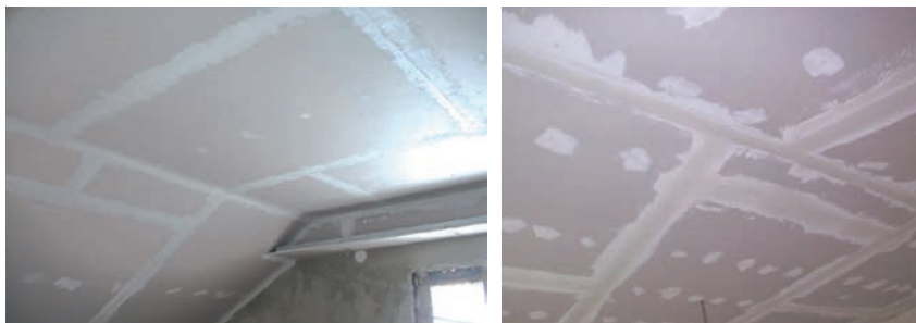
Slika 4-44 Izgled pokitanog plafona [58]
