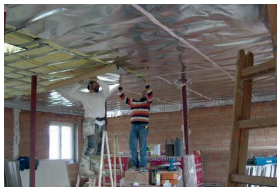
Slika 3-4 Prikaz postavljanja paronepropusnog sloja (pame brane) u slučaju unutarnje izolacije podgleda stropa [155]
