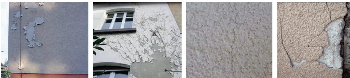
Slika 2-99 Djelomično oljuštena završna žbuka ETICS sustava, porozna struktura žbuke [127], [40]
