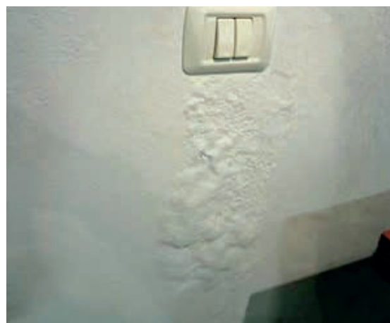
Slika 4-6 Primjer bubrenja žbuke zbog spriječenog isušivanja [174]
