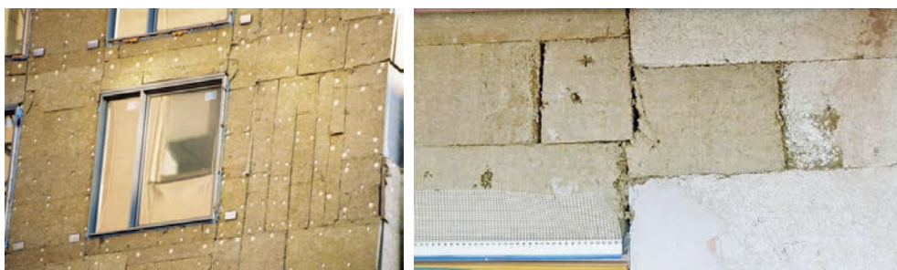
Slika 2-90 Neadekvatno postavljanje ploča toplinsko-izolacijskog materijala [124], [125]
