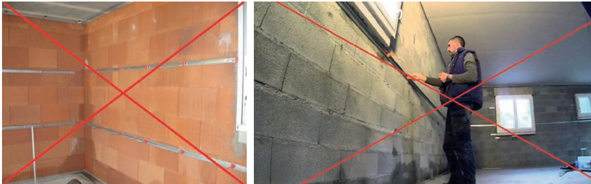
Slika 3-9 Vlažni zidovi prije izvođenja sustava unutarnje toplinske izolacije [10]
