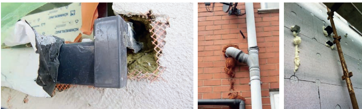
Slika 2-100 Loše izvedeni i nezabrtvljeni prodori ETICS sustava [127], [133], [134]
