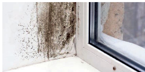
Slika 3 8 Rast gljivica i plijesni zbog kondenzacije na špaleti prozora [157]
