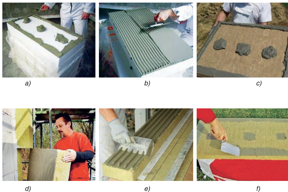
Slika 2-27 Nanošenje ljepila ovisno o vrsti toplinsko-izolacijskog materijala: a) EPS trakasto po rubu, točkasto u sredini; b) EPS punoplošno; c) MW ploča trakasto po rubu, točkasto u sredini; d) MW ploča punoplošno; e) MW lamela punoplošno; f) izvođenje kontaktnog sloja [10]
