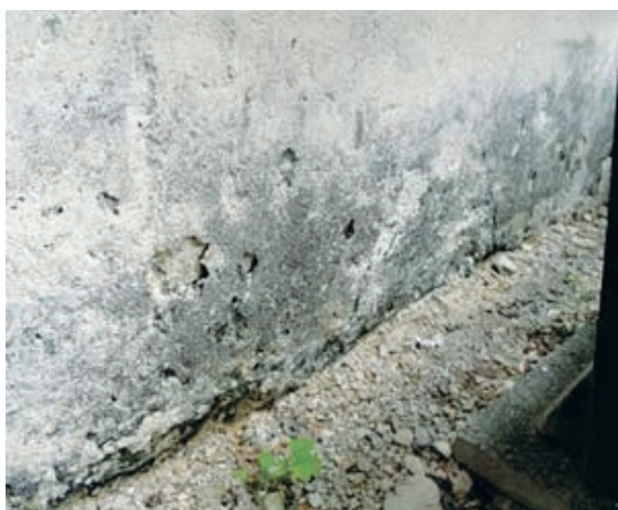
Slika 4-3 Primjer oštećenja žbuke zbog kapilarnog dizanja vlage i oborinske vode [174]
