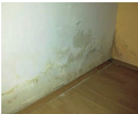
Slika 4-5 Primjer oštećenja nastalog zbog lošeg izvođenja spoja hidroizolacije [174]
