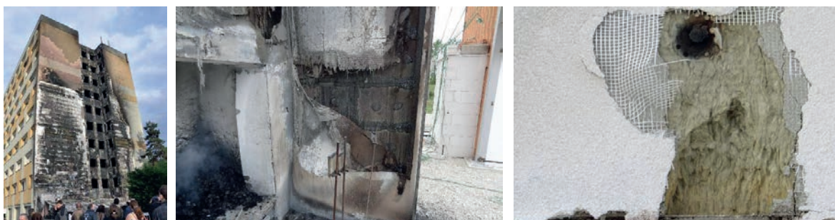
Slika 2-109 Oštećenje uslijed požara. Izgled ETICS sustava nakon realnog požara EPS-a i mineralne vune (ispitivanje prema BS 8414) [143], [10], [144], [40]
