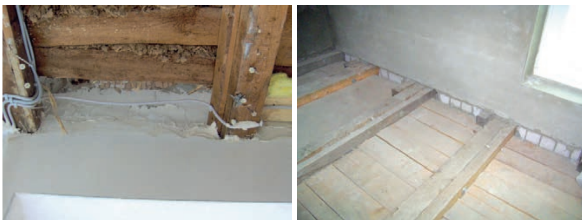
Slika 3-54 Primjeri nezabrtvljenih proboja greda drvenih stropova prilikom energetske obnove zgrade [247]
