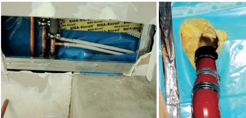
Slika 6-4 Loše zabrtvljeni prodori kroz zrakonepropusnu ovojnicu drvene zgrade [398]
