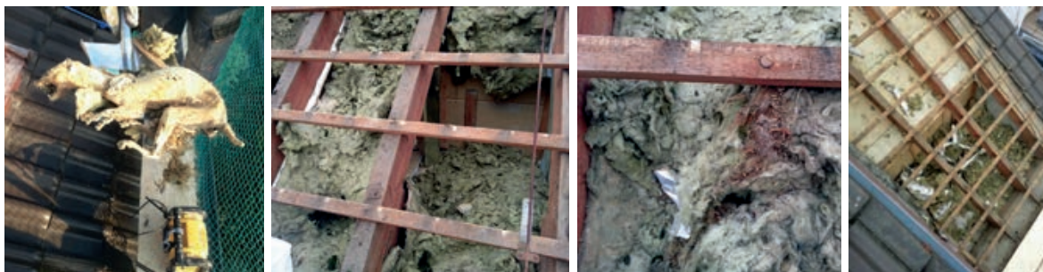
Slika 3-171 Oštećenje toplinske izolacije zbog glodavaca [320]
