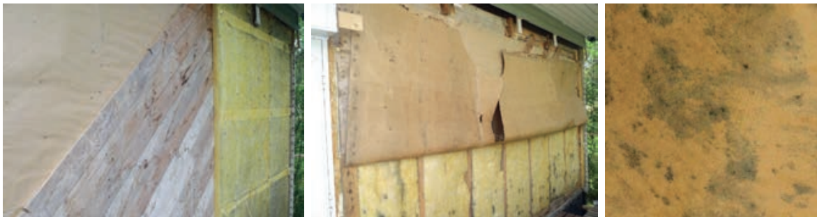
Slika 6-5 Primjer pojave plijesni u sloju toplinske izolacije zbog lošeg odabira materijala "kišne brane" (odabran paronepropusni papir) uz zrakonepropusnu unutarnju oblogu [206]
