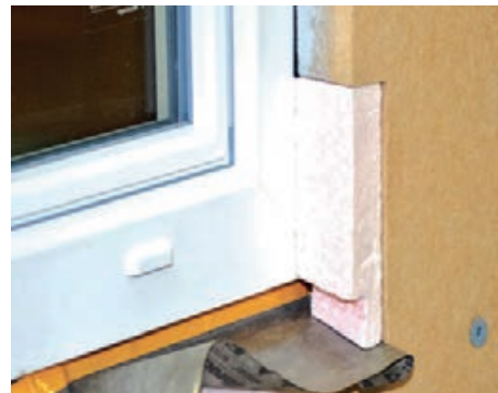
Detalj napuštene paropropusno- vodonepropusne folije na prozoru; ETICS sustav; detalj zaštite od prskanja i prodora vode
