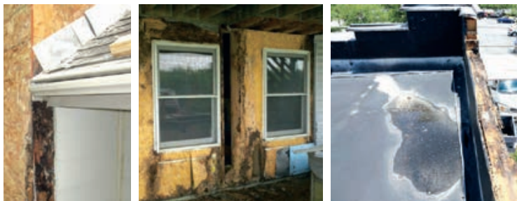
Slika 6-13 Truljenje drvene konstrukcije zbog loše izvedenih limarskih i krovopokrivačkih radova [388], [407]
