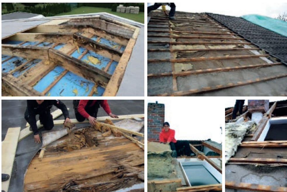
Slika 3-166 Primjer vlažnog i trulog drvenog krova [316]
