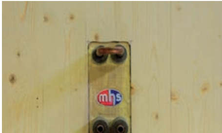
Ugradnja specijalnog fazonskog komada za priključenje radijatora (gornje cijevi) i dovod te odvod dvocijevnog sustava grijanja u slojevima poda (donje cijevi)
