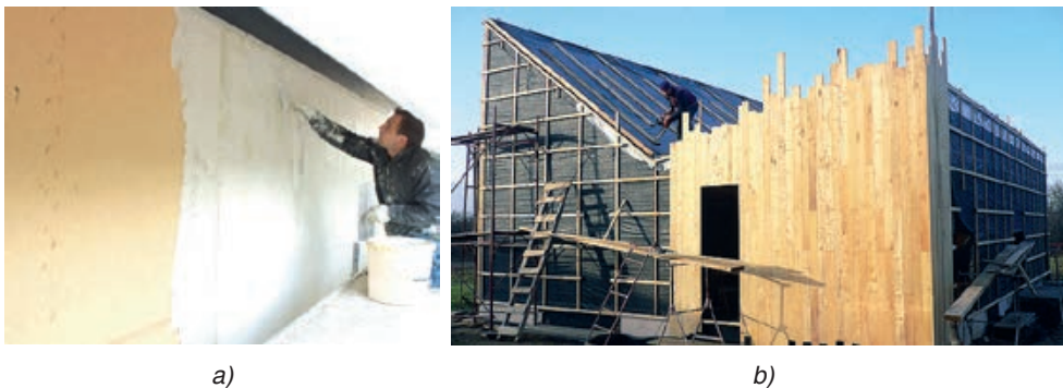
Slika 3-25 Primjeri dodatne vanjske izolacije drvene kuće: a) izvođenjem ETICS sustava te b) izvođenjem ventilirane fasade [235], [236]
