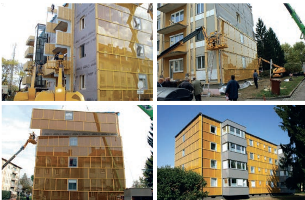
Slika 2-90 Primjer montaže predgotovljenih drvenih panela prilikom energetske obnove postojeće zgrade u Austriji [214]
