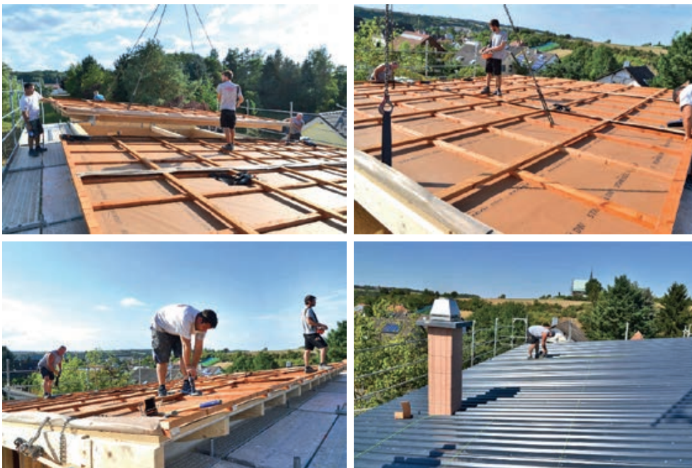
Slika 3-194 Primjer izvedbe ventiliranog krova s pokrovom od trapeznog lima korištenjem predgotovljenih krovnih elemenata [251]
