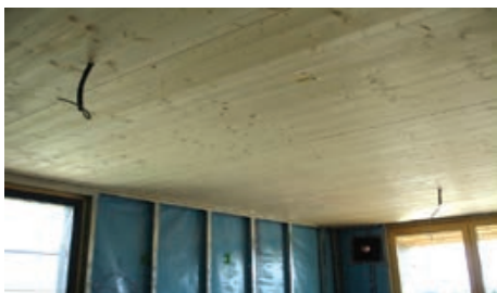
Prodor električnih instalacija kroz stropnu ploču, razvod s gornje strane u slojevima poda
