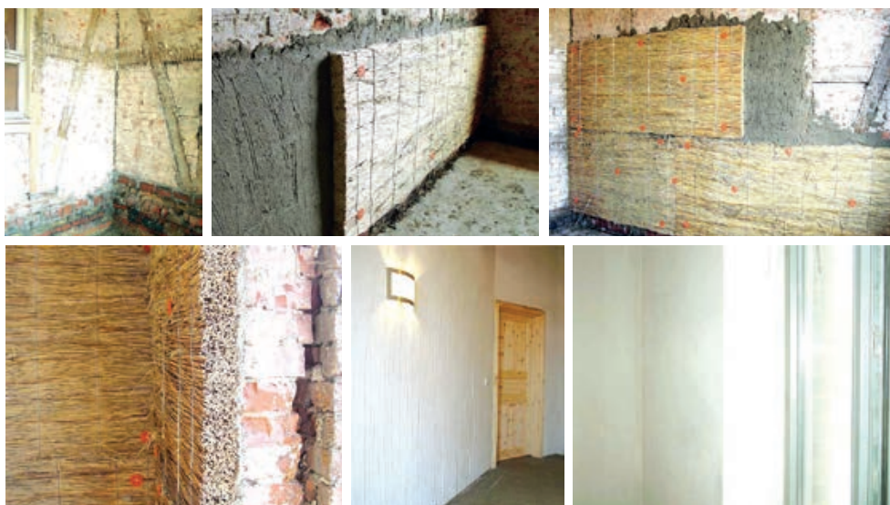
Slika 4-27 Primjer korištenja trstike za unutarnju izolaciju kod obnove postojeće zgrade iz 1930. godine [386]
