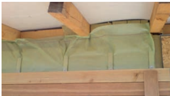
Slika 3-68 Pogrešna izvedba kišne brane korištenjem PE folije [267], [268]
