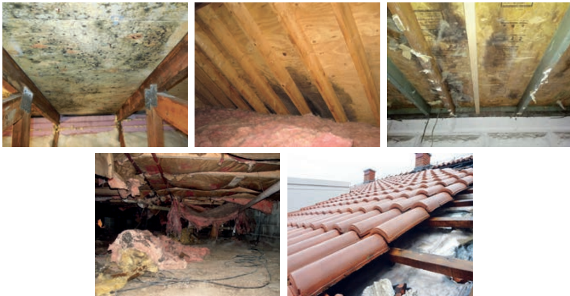
Slika 3-176 Štete uzrokovane lošom zrakopropusnošću [324], [325], [326], [327], [328]
