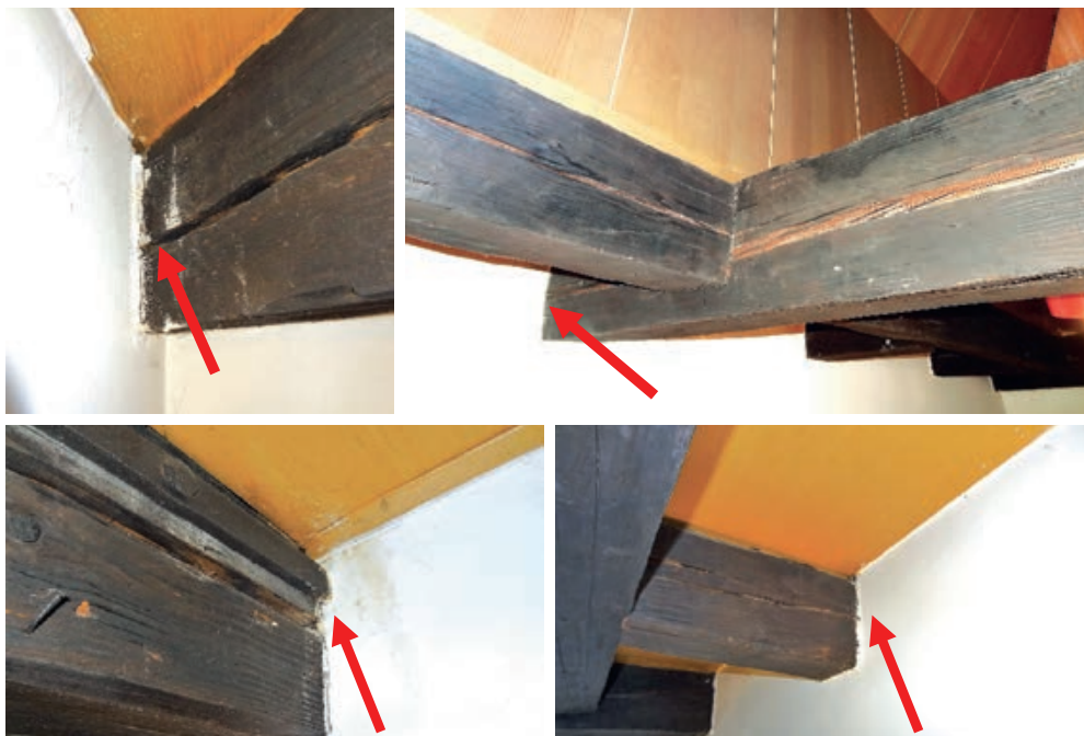
Slika 3-58 Primjeri lošeg brtvljenja prodora drvenih greda kroz ožbukanu vanjsku ovojnicu zgrade – problem raspucalosti greda zbog sušenja [13]
