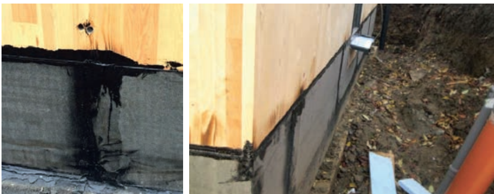
Slika 3-2 Prikaz hidroizolacije podnožja zgrade od masivne drvene stijene prije izvedbe ETICS fasadnog sustava [217]
