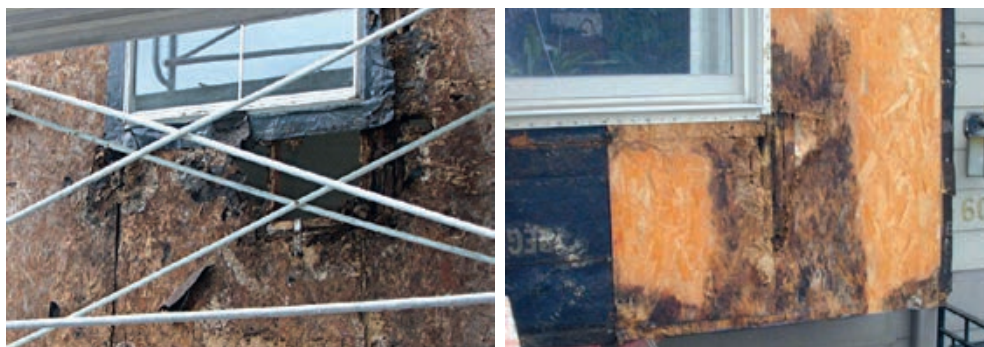
Slika 6-12 Građevinska šteta (truljenje drvene konstrukcije) nastala zbog loše izvedbe (brtvljenja) “kišne brane” zgrade pri ugradnji prozora [388]
