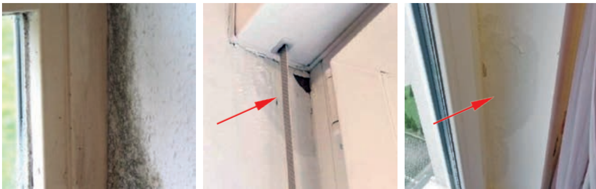
Slika 3-131 Pojava gljivica i vlaženja zida zbog loše ugradnje prozora [13]
