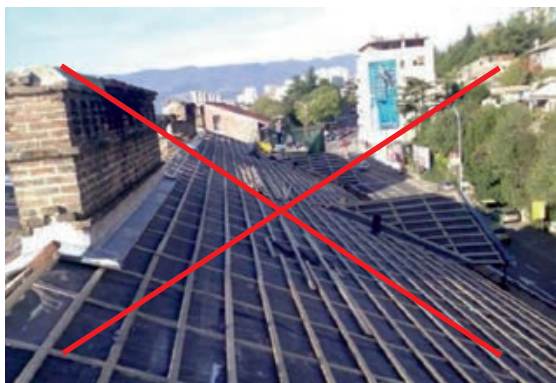
Slika 3-162 Primjer bitumenske ljepenke na krovu, koju treba izbjegavati [314]
