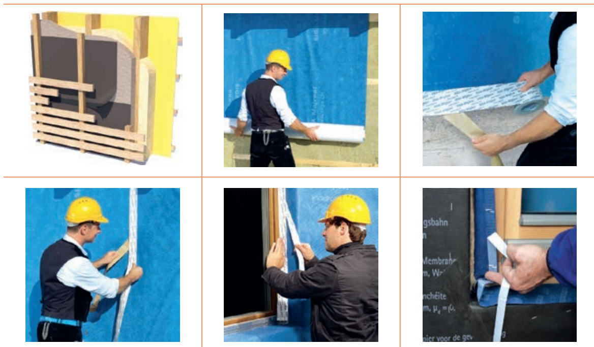
Tablica 3-6 Primjer postavljanja paropropusno-vodonepropusne folije na drvenu potkonstrukciju ventilirane fasade drvene zgrade [266]
