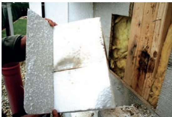
Slika 6-7 Vlažna izolacija i truljenje drva kod ETICS sustava s EPS-om izvedenog na drvenu okvirnu konstrukciju [400]
