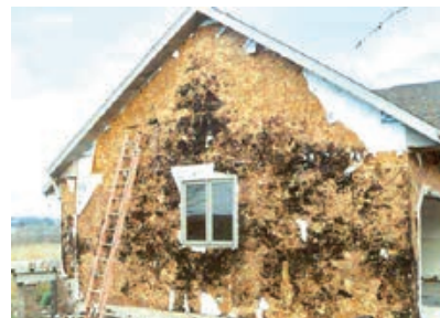
Slika 6-14 Truljenje drvene konstrukcije zbog sušenja vanjske obloge zgrade prema unutra uslijed djelovanja sunca [388]
