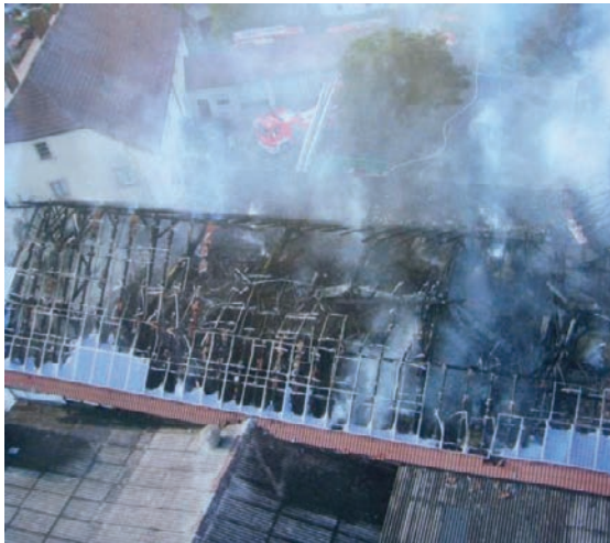
Slika 3-28 Požar fotonaponskih panela [75]
