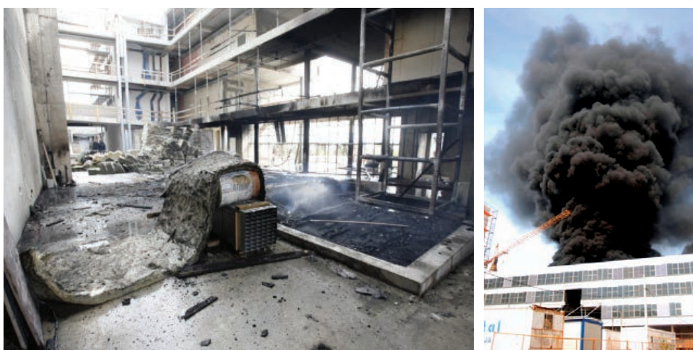
Slika 3-25 Požar na Sveučilišnom kampusu u Rijeci tijekom gradnje (travanj 2009.) [70], [71]
