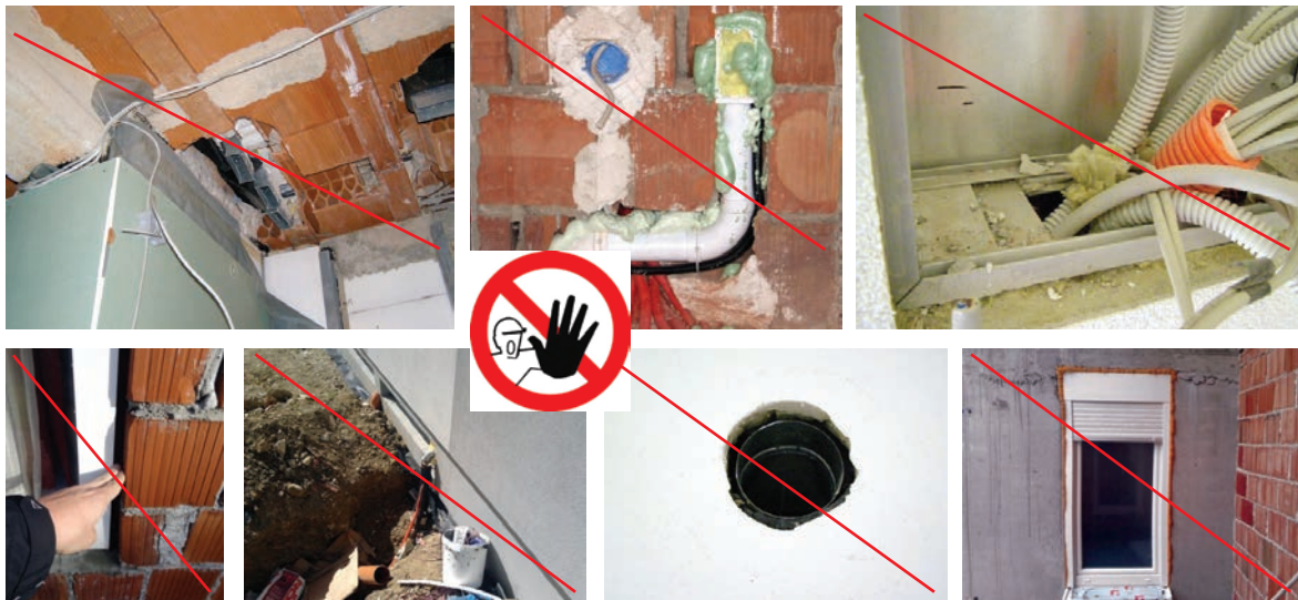
Slika 5-11 Primjeri lošeg izvođenja građevinskih radova – potencijalna slaba mjesta na vanjskoj ovojnici zgrade [11]
