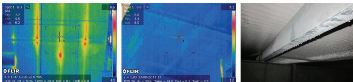
Slika 5-24 Brtvljenje laganih sendvič panela; nezabrtvljeni spoj (lijevo), zabrtvljeni spoj (sredina), kondenzacija vode (desno) [11]
