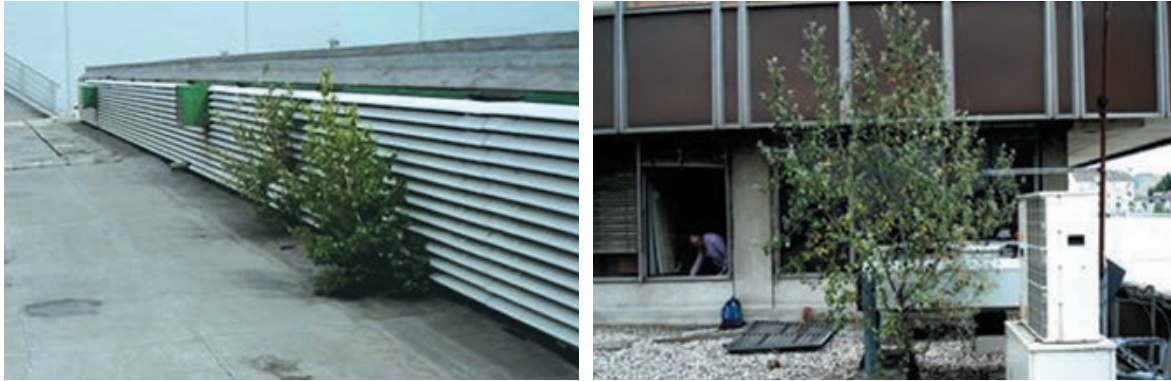
Slika 3-248 Primjeri lošeg održavanja krova [207]
