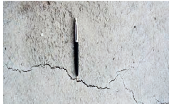
Slika 1-76 Pojava pukotina na površini betona zbog nepravilne njege betona [56]
