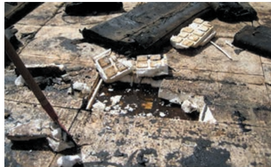
Slika 3-249 Primjer oštećenja termoizolacije i vode ispod sloja termoizolacije [207]
