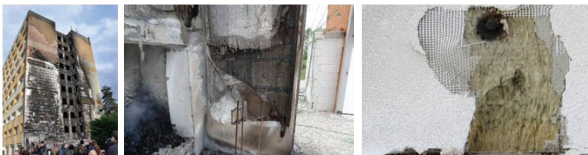
Slika 3-168 Oštećenje uslijed požara, izgled ETICS sustava nakon realnog požara EPS-a i mineralne vune (ispitivanje prema BS 8414) [173], [9], [174], [146]
