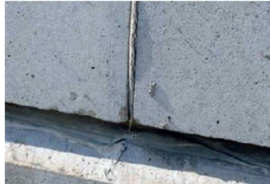
Slika 3-198 Primjer deformacije brtvila uslijed deformacije zidnih panela [185]
