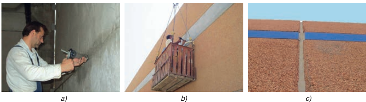
Slika 3-204 Brtvljenje sljubnica predgotovljenih betonskih panela s unutrašnje strane a) , odnosno vanjske strane b) , obrađena sljubnica c) [184]
