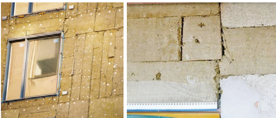
Slika 3-149 Neodgovarajuće postavljanje ploča toplinsko izolacijskog materijala [155], [156]
