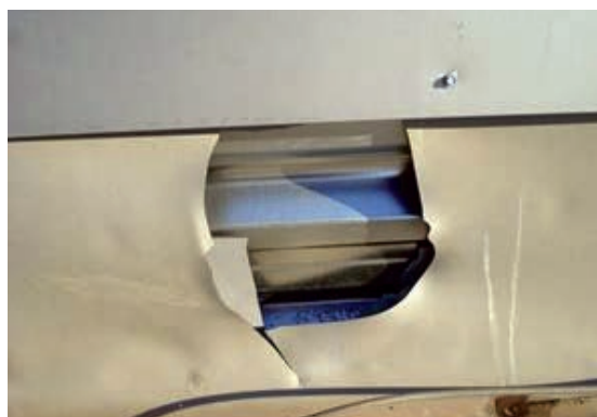
Slika 3-246 Oštećenje hidroizolacije zbog nedostatka UV stabilizatora [207]
