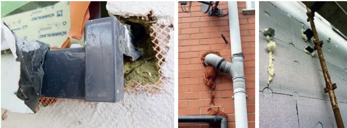
Slika 3-159 Loše izvedeni i nezabrtvljeni prodori ETICS sustava [158], [164], [165]
