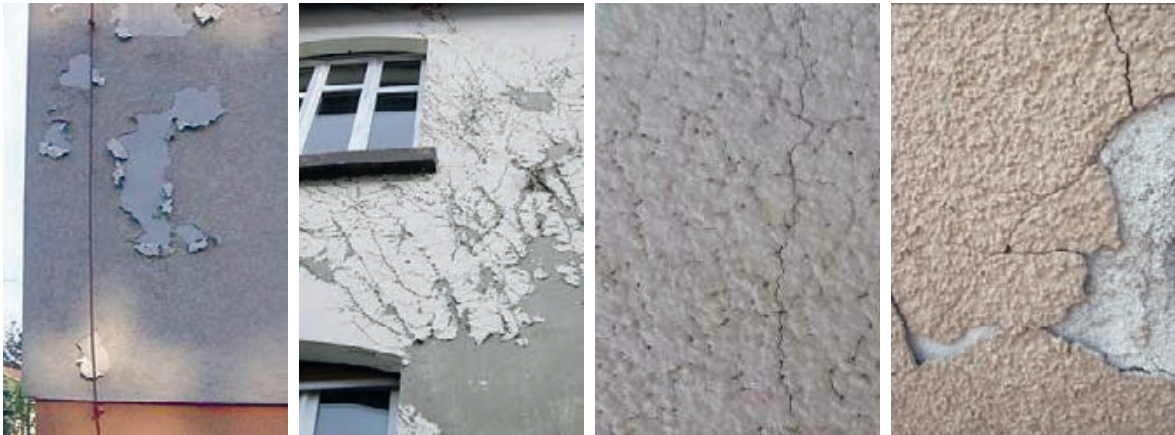
Slika 3-158 Djelomično oljuštena završna žbuka ETICS sustava, porozna struktura žbuke [158], [146]
